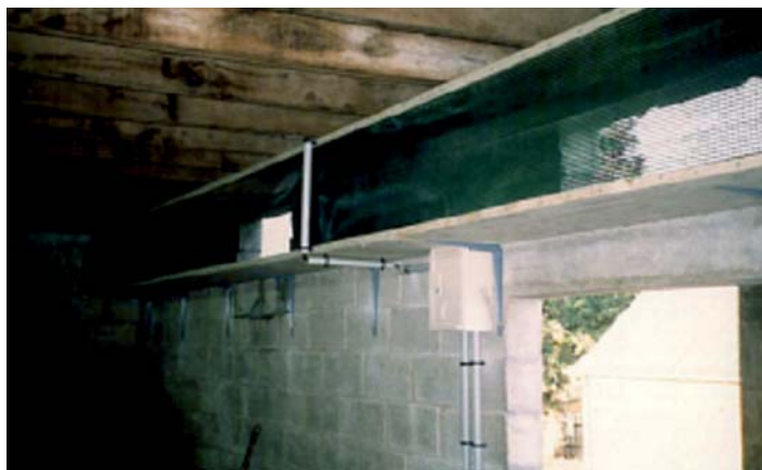
Entrée d'air par un caisson diffuseur
